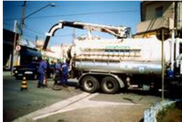
Veículo de limpeza de galerias.
